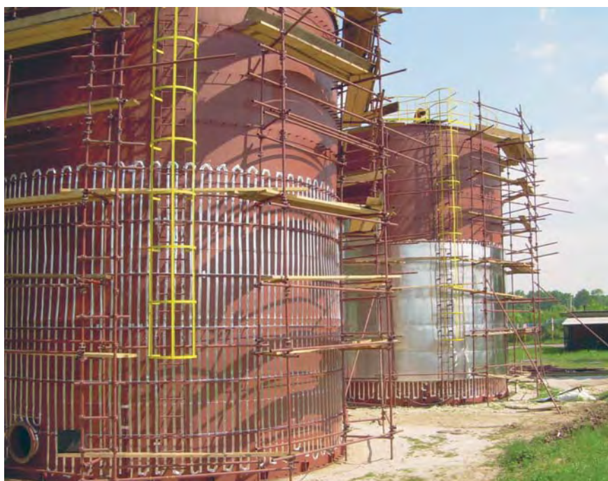
Нагревательные кабели, расположенные на резервуаре
